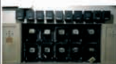
AUMENTO DE CARGA E MODERNIZAÇÃO DE PCs
