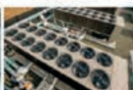
SISTEMAS DE CLIMATIZAÇÃO
