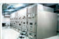
SUBESTAÇÕES DE ENERGIA
