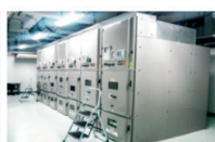
SUBESTAÇÕES DE ENERGIA
