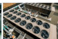
SISTEMAS DE CLIMATIZAÇÃO
